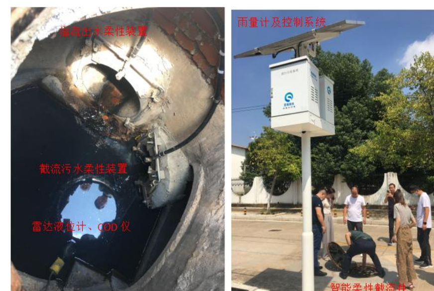
智能柔性截流井内和井外配套设施现场照片
